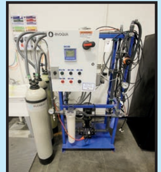
EVOQUA DI WATER SYSTEM
