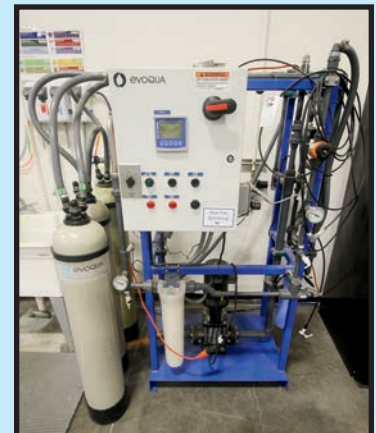
EVOQUA DI WATER SYSTEM
