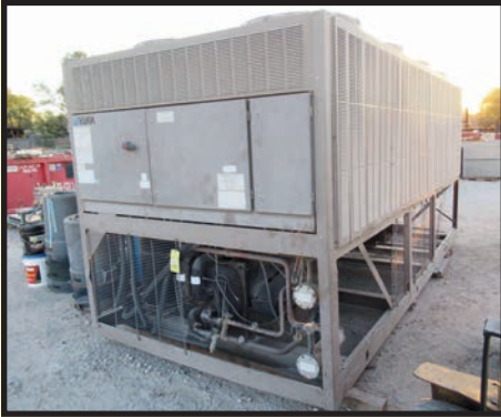
YORK 125 T. CAP. CHILLER
